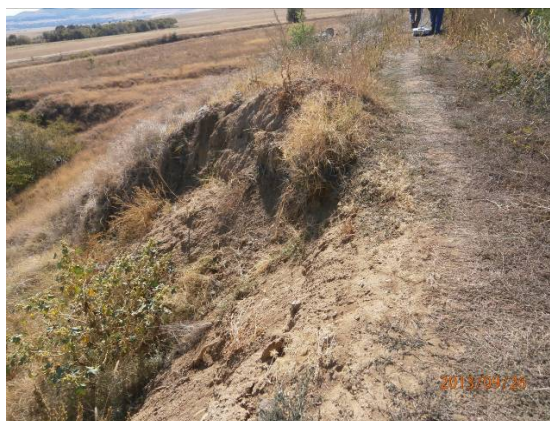
Фиг. 1. Свлачищен процес от въздушната страна на язовирната стена, яз. Блатница
